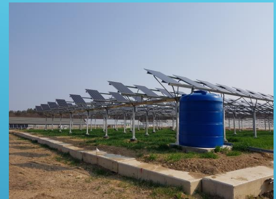
집수 Tank 5 ton
